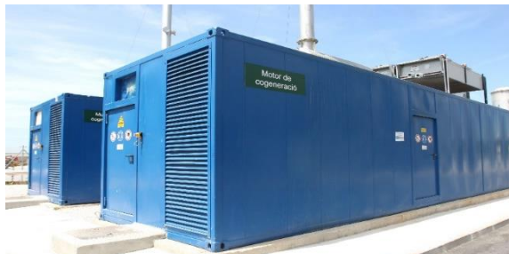
MOTORS DE COGENERACIÓ
